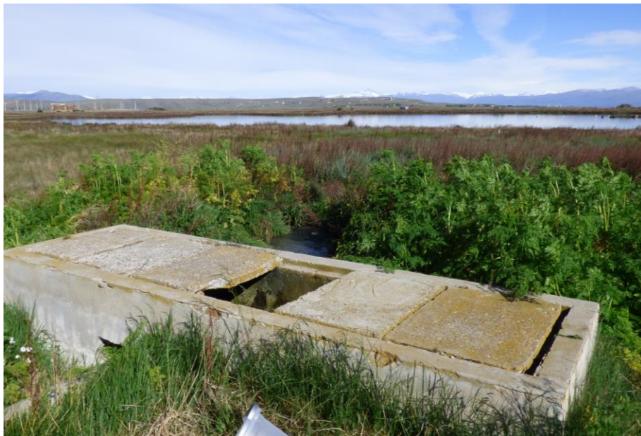
Fotografía 4: Cisterna de ingreso del agua tratada a la laguna Nimez (Estación 2).
