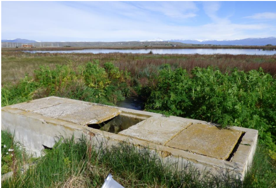
Fotografía 3: Cisterna de ingreso del agua tratada a la laguna Nimez (Estación 2).
