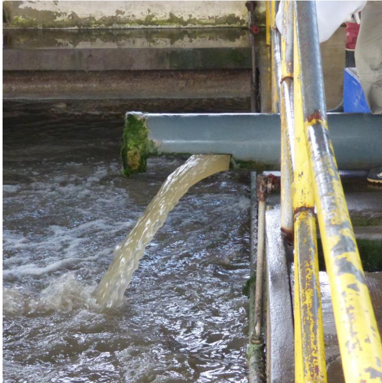
Fotografía 2. Ingreso de agua a la Planta de Tratamiento (Estación 1)
